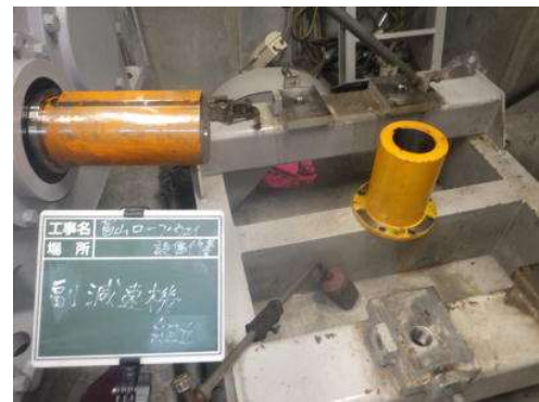
副減速機整備
