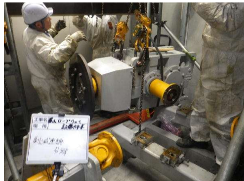
副減速機整備
